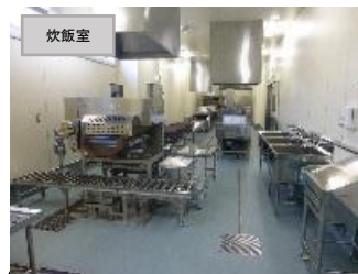
ご飯を炊く連続炊飯機が設置された炊飯室です。炊飯室専用の洗浄機も設置されています
