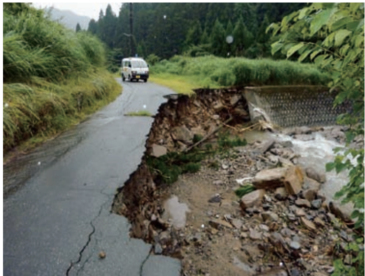
平成21年8月台風による被害（葛蒲沢）
