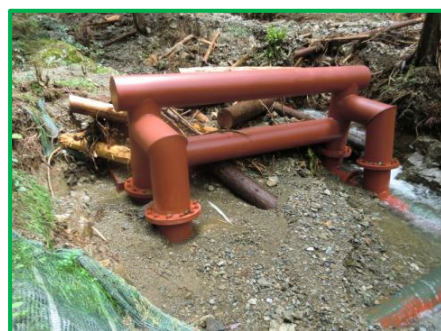
▲：簡易流木止め施設
