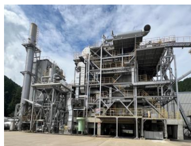
木質バイオマス発電所
