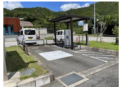
電気自動車の充電設備
