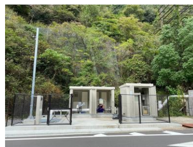
生野マイクロ水力発電所
