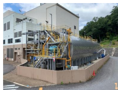
バイオガス発電・熱利用設備
