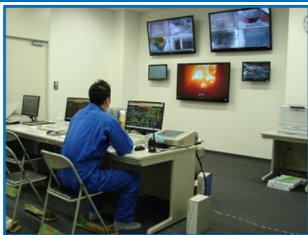
▲：熱回収設備(中央制御室)
