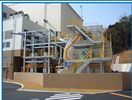
▲：バイオマス設備
