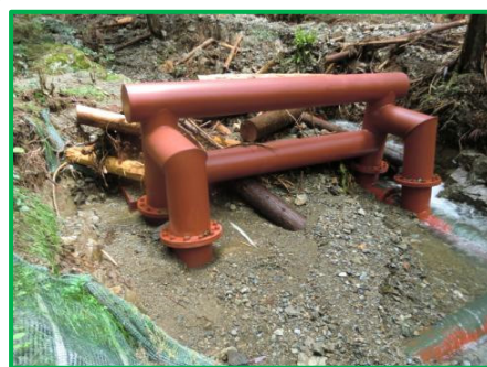
▲：簡易流木止め施設
