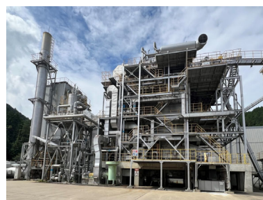
木質バイオマス発電所
