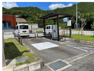
電気自動車の充電設備
