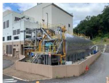
バイオガス発電・熱利用設備
