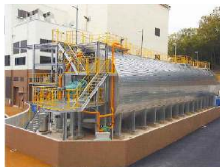
＜メタン発酵槽＞
