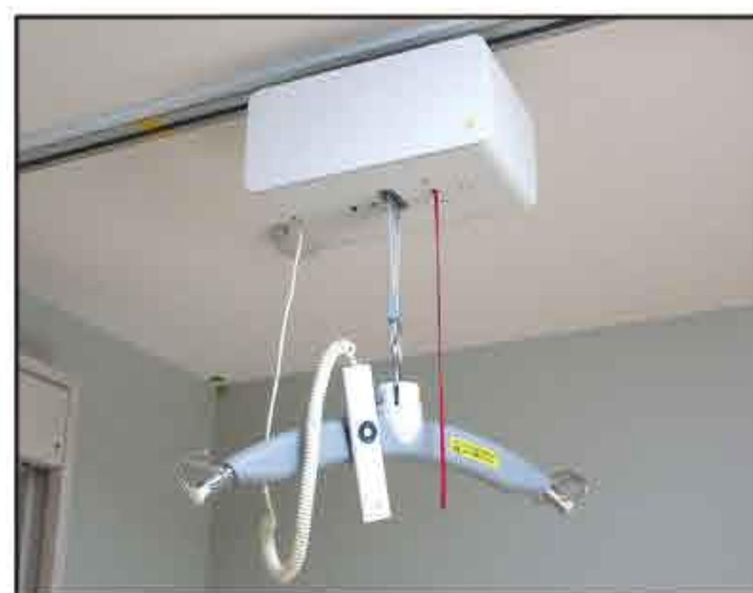
腰痛予防のためリフトを設置
