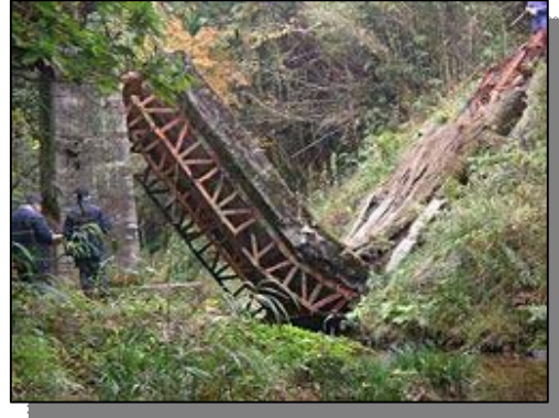
香川・徳島県境（2007年） 無名橋（トラス橋）の落橋 出典：構造物メンテナンス研究センター （CAESAR・シーザー）
