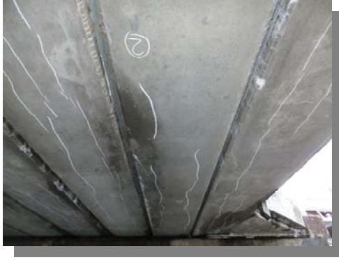
コンクリート桁にひびわれが発生しています。
