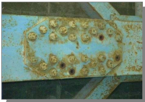
橋桁のボルトが脱落しています
