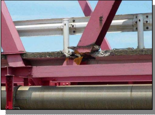
三重県 国道23号 木曾川大橋（トラス橋）の鋼材の破断 出典：国土交通省
