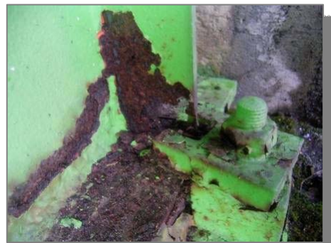
橋桁が腐食し穴が空いています
