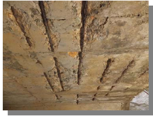
コンクリートが剥離し鉄筋が見えています。
