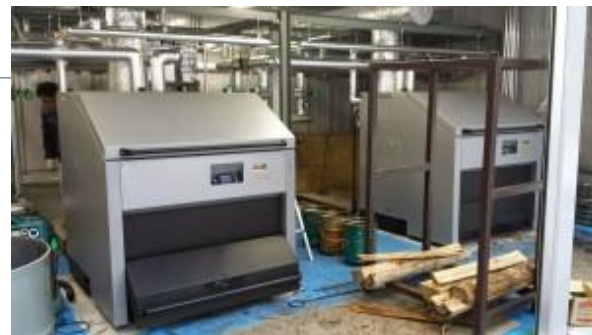
岡山県西粟倉村の村営温浴施設への薪ボイラー導入
