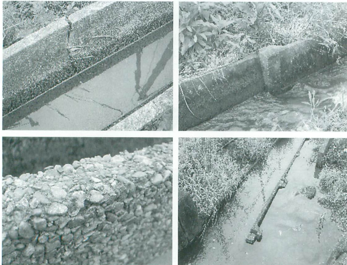
▲農業用水路の老朽化が進行し、ひびわれや、欠損により機能が低下しています。
