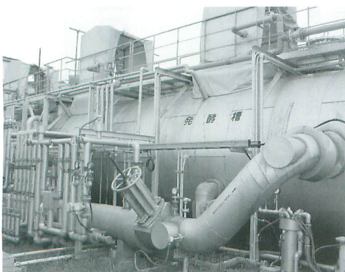
▲バイオガス化実証プラント(京都市)
