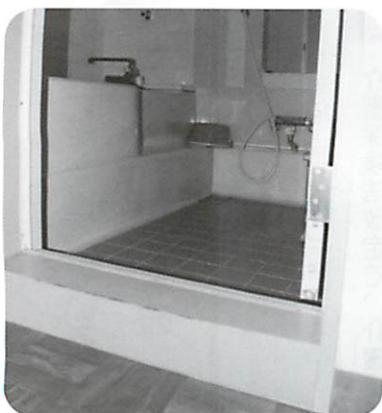
転倒の恐れのある風呂場の段差
