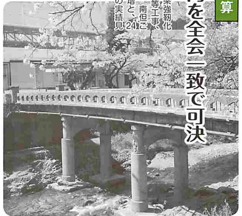
▲老朽化が激しい橋梁
