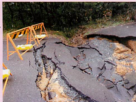
↑台風18号による被災状況(佐の(高原)早期復旧が望まれる。
