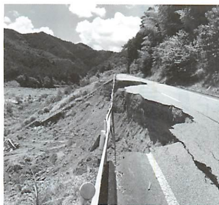
▲被災した市道一品金浦線の様子
