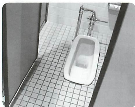
▲ジュピターホールの子女子トイレは、洋式化へ抜本的改善が必要です
