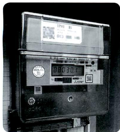
▲普及するスマートメーター 情報収集機能の防災への 利活用を期待する
