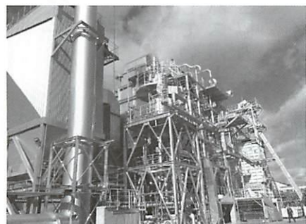
▲生野工業団地内のバイオマス発電所
