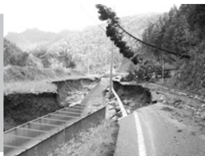
土砂崩れにより陥没した林道山東朝来線
