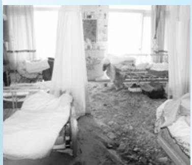
土砂に埋まった施設内の様子
