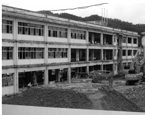
施工不良箇所が見つかった南校舎（8月撮影）
