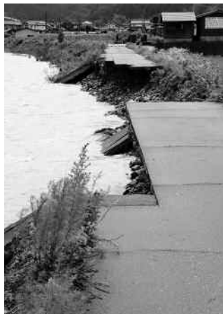
新井の円山川左岸では、堤防が削られるも、大きな被害には至りませんでした。
