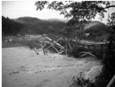
▲台風9号による豪雨で市内各地で被害 (平成21年8月)
