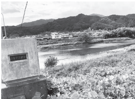
▲寺谷橋下流の未改修堤防
